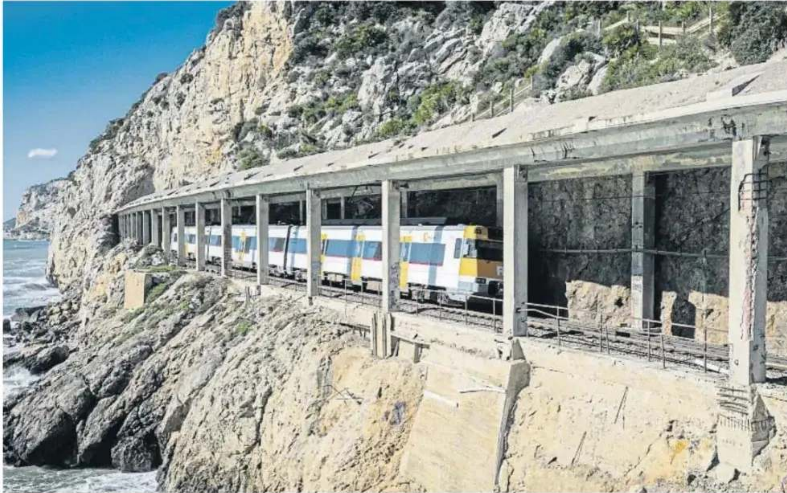
Un tren de Rodalies circula por la línea del Garraf bajo una estructura visiblemente maltrecha
